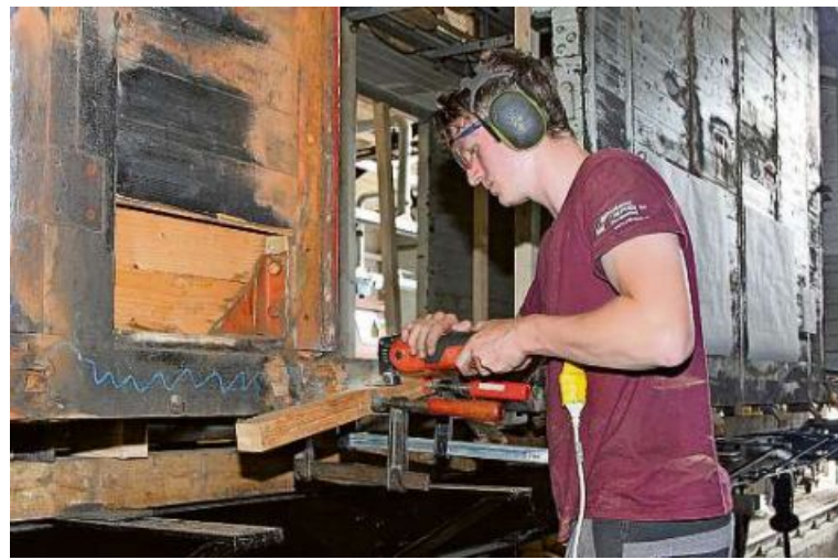
Präzisionsarbeit: Niklas Käslin, Schreinerlehrling im 2. Lehrjahr, bereitet einen Teilaustausch des morschen Balkens vor.
