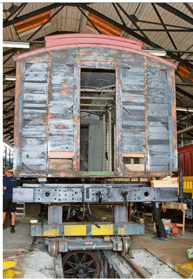
Schmuckstück: Der alte Postbahnwagen aus dem Jahr 1908 wird im Lokdepot Rapperswil komplett renoviert.
